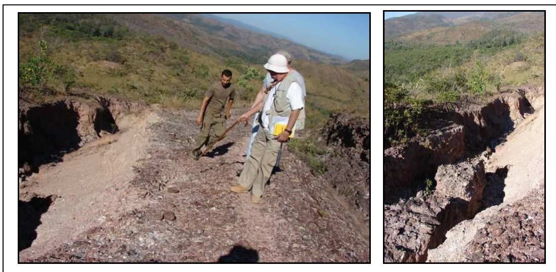
Foto 25. Voçoroca oriunda de leito de estrada antiga abandonada, no interior da RNST
